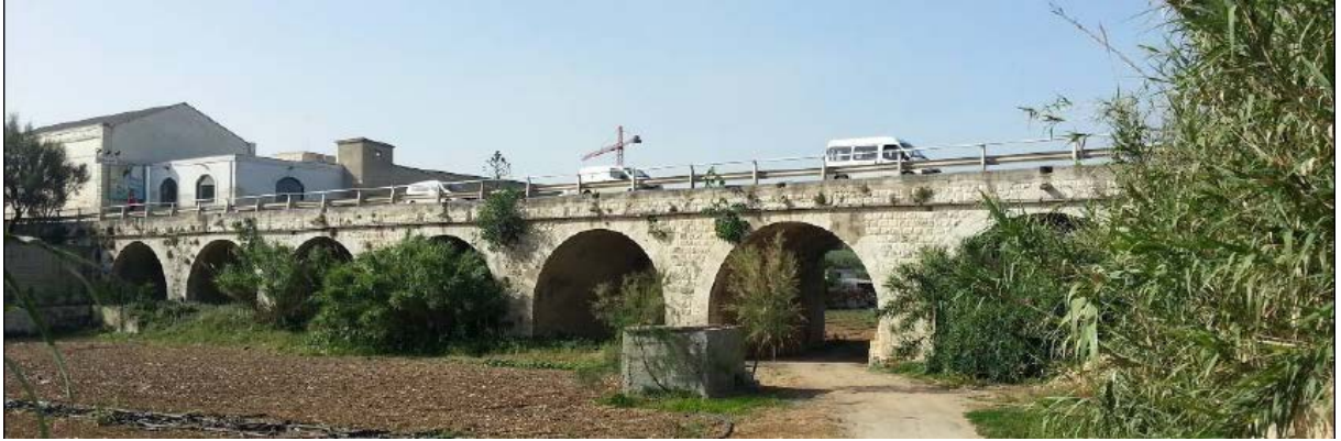
Figura 4.3-2: Tratto Lama Martina - Ponte in pietra con sette arcate lato mare (nord) – vista da valle
