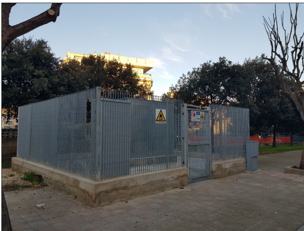
Figura 5 Cabina di riduzione della pressione del gas cittadino da spostare in via Salvador Allende
