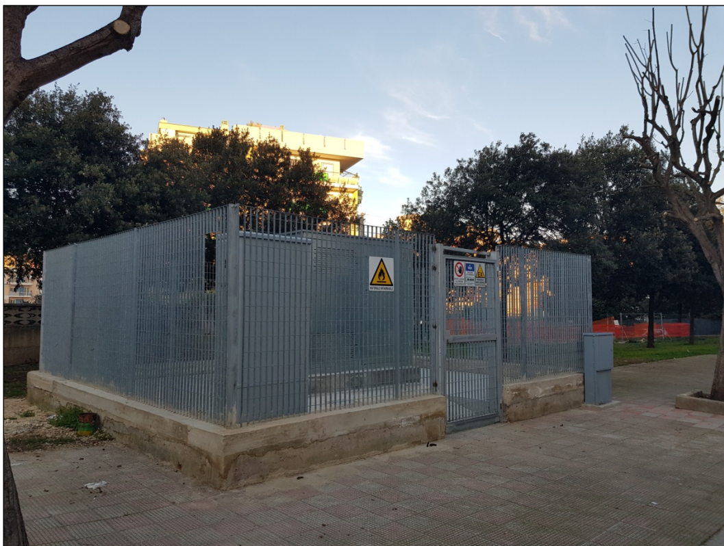
Figura 4 Cabina di riduzione della pressione del gas cittadino da spostare in via Salvador Allende
