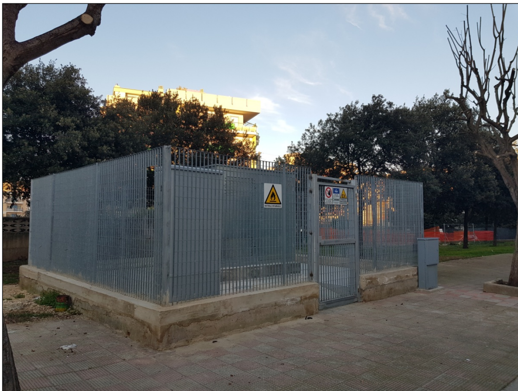
Figura 4 Cabina di riduzione della pressione del gas cittadino da spostare in via Salvador Allende
